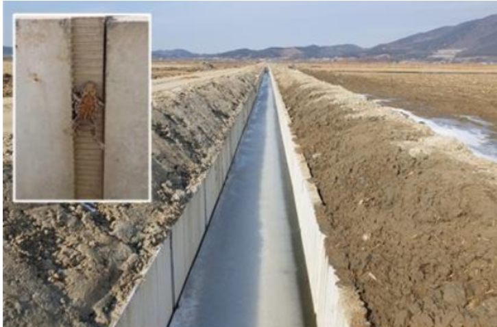
서산 간척지 농수로에 설치된 생태 친화적 콘크리트 수로 구조물
