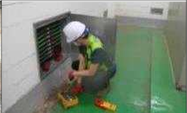
배수장 전기 접지저항측정
