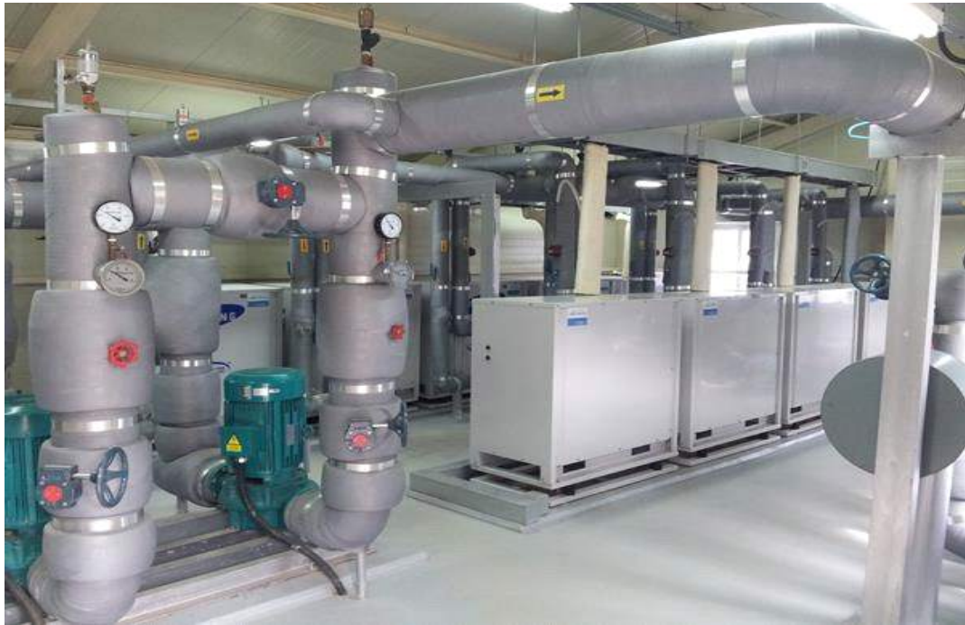
화훼온실 지열 히트펌프 전경
