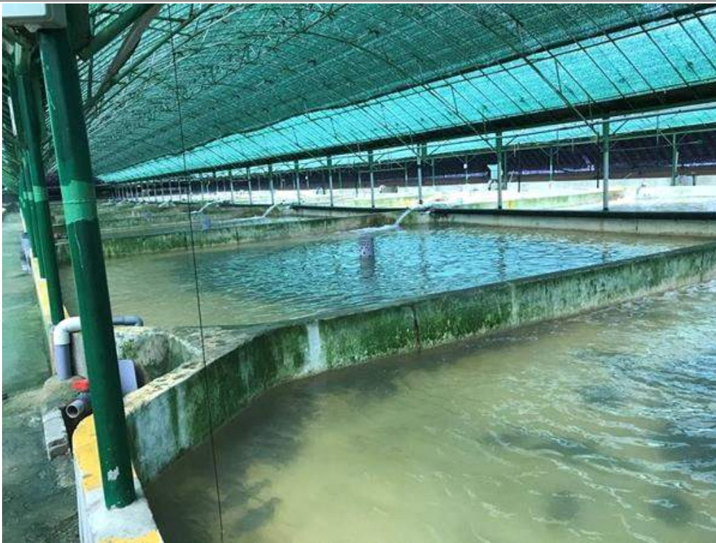
양식장 냉온수 공급 전경
