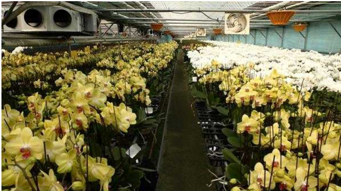
화훼온실 내부 지열냉난방시설 전경
