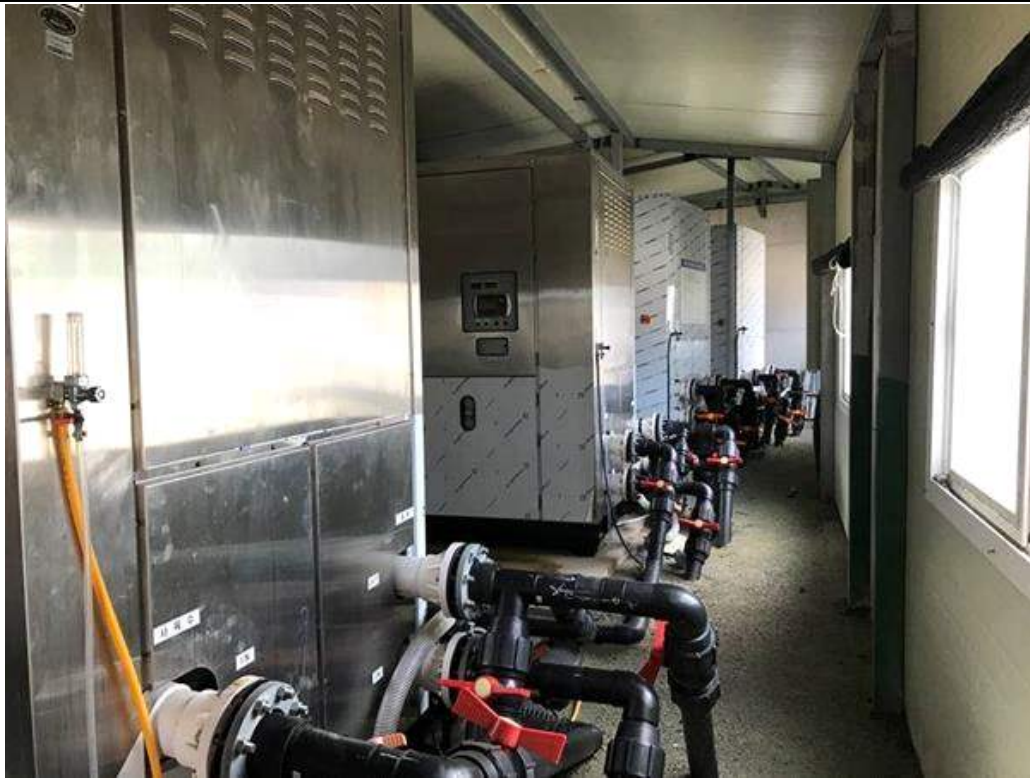
양식장 해수열 히트펌프 전경
