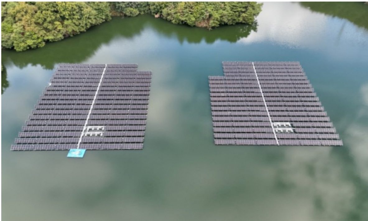
회룡저수지에 설치된 수상태양광발전소. 사진=한국농어촌공사 문경지사 제공
