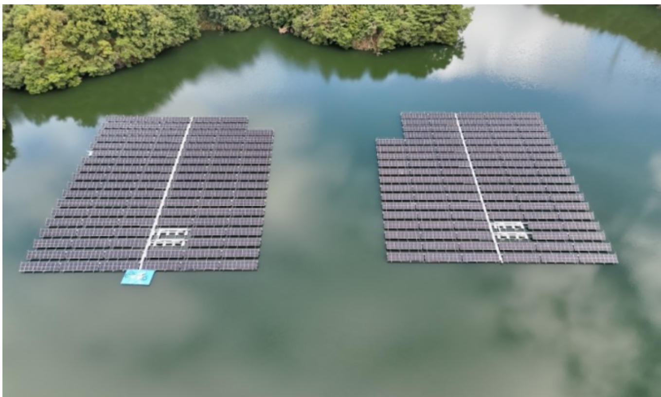
▲ 문경시 산북면 회룡저수지에 설치된 수상태양광발전소 전경.
