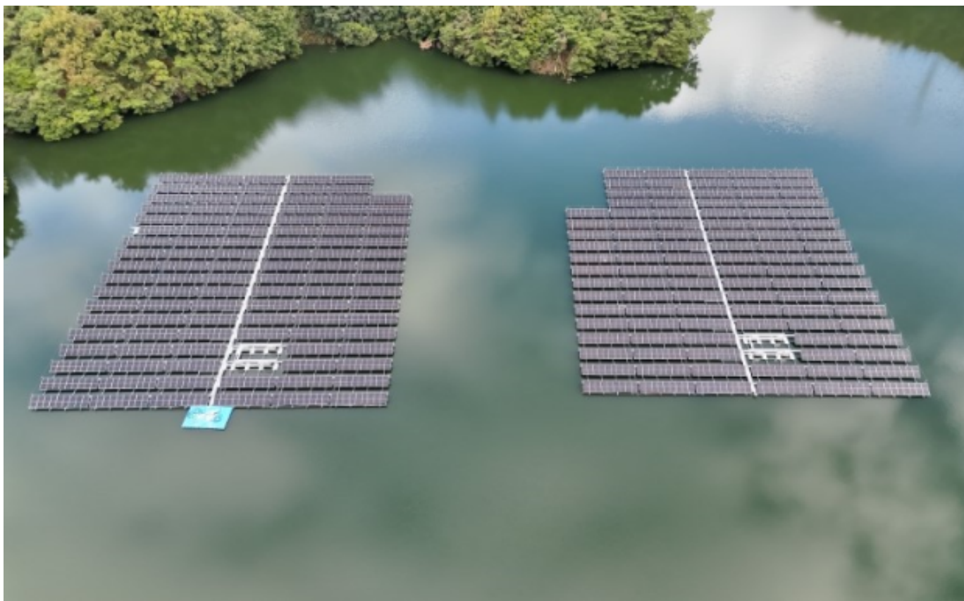
문경시 산북면 회룡저수지에 999kW급 수상태양광발전소가 준공돼 본격적인 상업운전에 들어갔다. 농어촌공사 문경지사 제공
