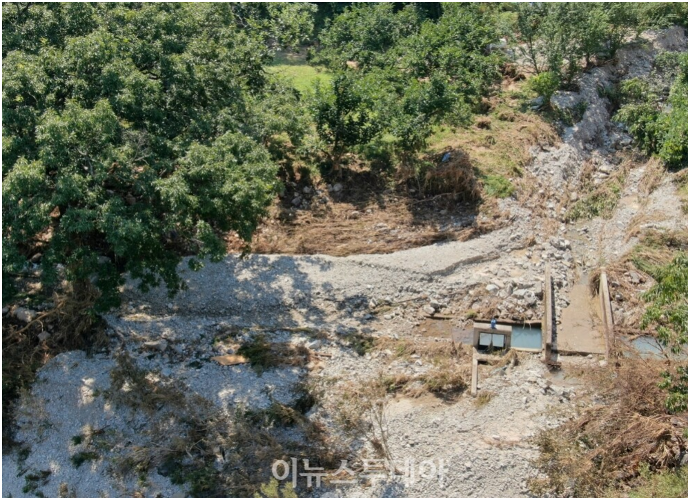
산청군 단성면 자양용수간선, 산사태로 인한 취입수로 파손 지역 드론 촬영 [사진=한국농어촌공사 진주산청지사]
