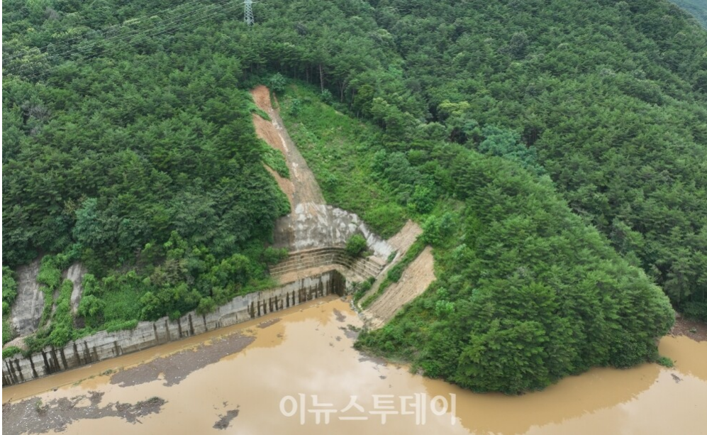
산청군 신등면 율현저수지, 사면유실 및 방수로 파손 지역 드론 촬영 [사진=한국농어촌공사 진주산청지사]
