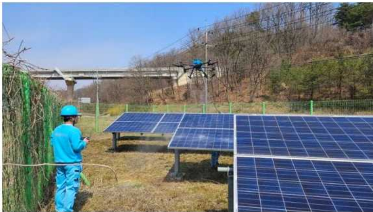
농어촌공사 보은지사 드론 활용 태양광 패널 청소작업 *재판매 및 DB 금지
